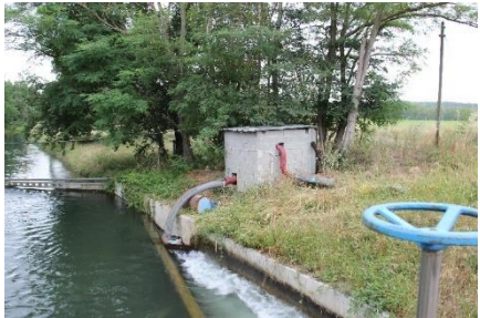
Captage d'eau du canal de St Martory
